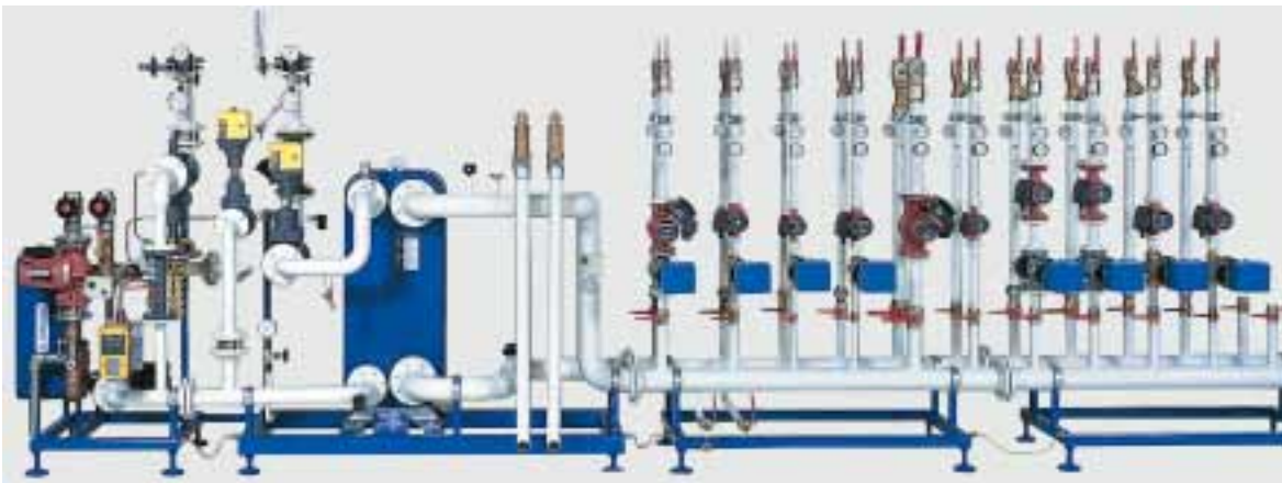
indirekter Anschluß mit 11 Heizkreisen und Trinkwassererwärmung
